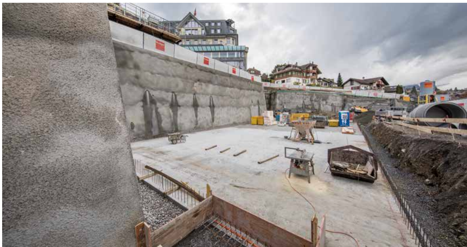
Alles musste schnell gehen: Innerhalb von nur sechs Wochen hat das Team der GSTB die Baugrubensicherung fertiggestellt.
