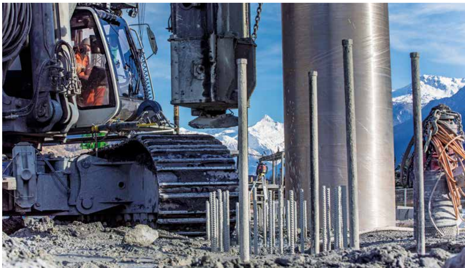
Die Dimensionen der Pfählungsarbeiten sind bis zum heutigen Zeitpunkt in der Schweiz einmalig.
